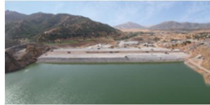
عملیات اجرایی سد مخزنی عباس آباد بانه Executive Operations of Abbas Abad Storage Dam in Baneh
