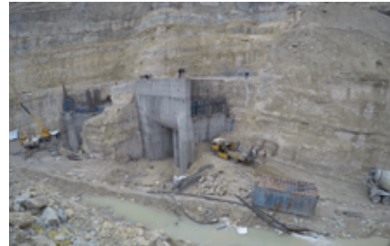
تونل انتقال آب سد پارسیان (استان فارس) Parsian dam (Fars Province)
